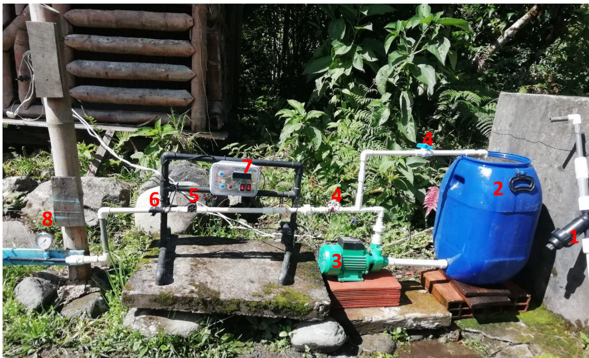
Figura 5. Disposición de la instalación experimental (Cabezal de control).
