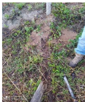
FIGURA 21. Deteriio de las mangueras encontradas.
