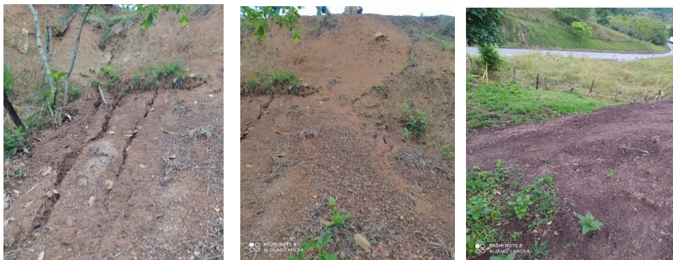
FIGURA 20. Suelo erosionado, y procesos de compactación en la ladera.
