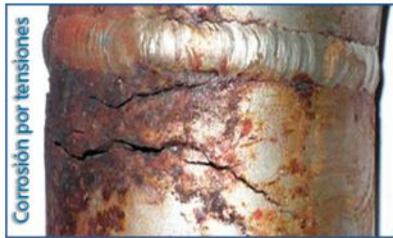
Ilustración 14. Corrosión por esfuerzos de tensión.
