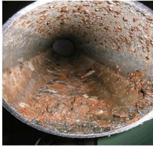
Ilustración 7. Corrosión uniforme o generalizada.
